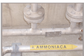
Figura 1 - Tubazione in servizio non certificata PED e destinata a contenere un fluido del gruppo 1
